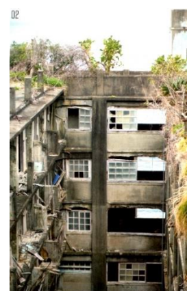
廃墟となったアパート
